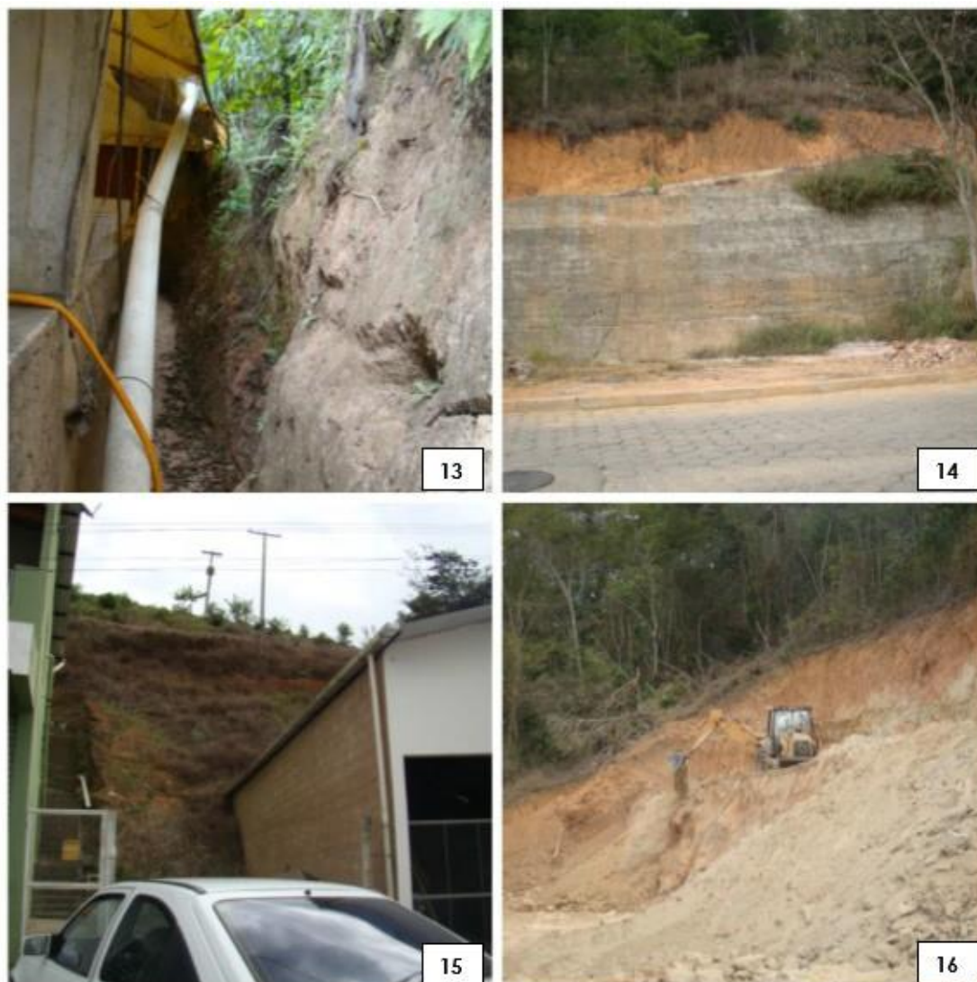
Foto 13: Distância de segurança inexistente entre edificação e talude de corte, impossibilitando qualquer forma de contenção no local. Foto 14: Muro com drenos, porém acima da via de acesso para o bairro, talude de corte sem nenhuma contenção. Foto 15: Residência muito próxima ao talude de corte. Foto 16: Detalhe da máquina escavando, sem supervisão e gerando taludes de corte verticais nos fundos do hospital municipal. Surgimento de uma nova área de risco.
