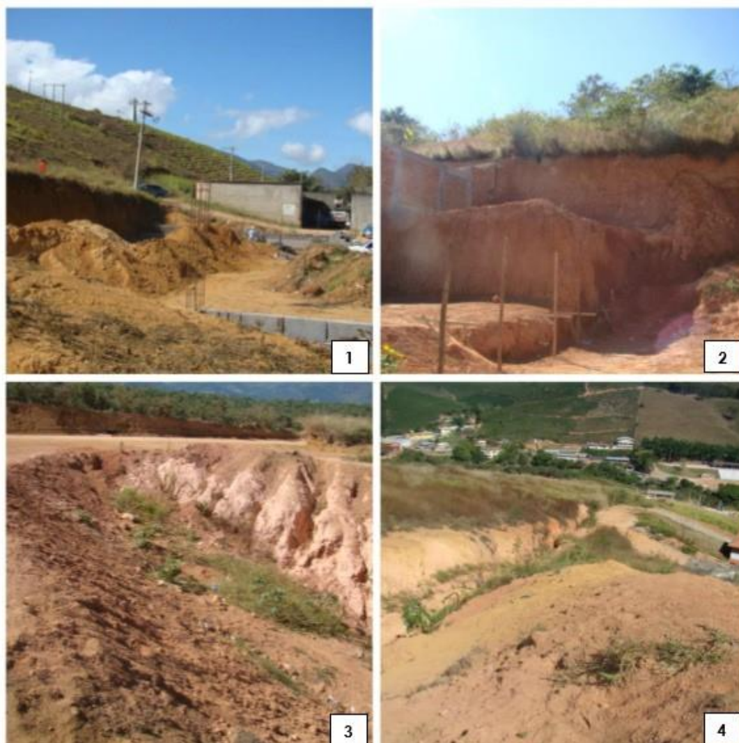
Foto 1: Muro de contenção sendo construído, sem orientação técnica. Foto 2: Cortes e aterros verticais por toda obra , sem apoio técnico. Fotos 3 e 4: a ausência de drenagem leva a criação de caminhos preferenciais das águas (sem ordenamento), gerando pontos de processos erosivos que evoluem de sulcos a ravinas rapidamente.
