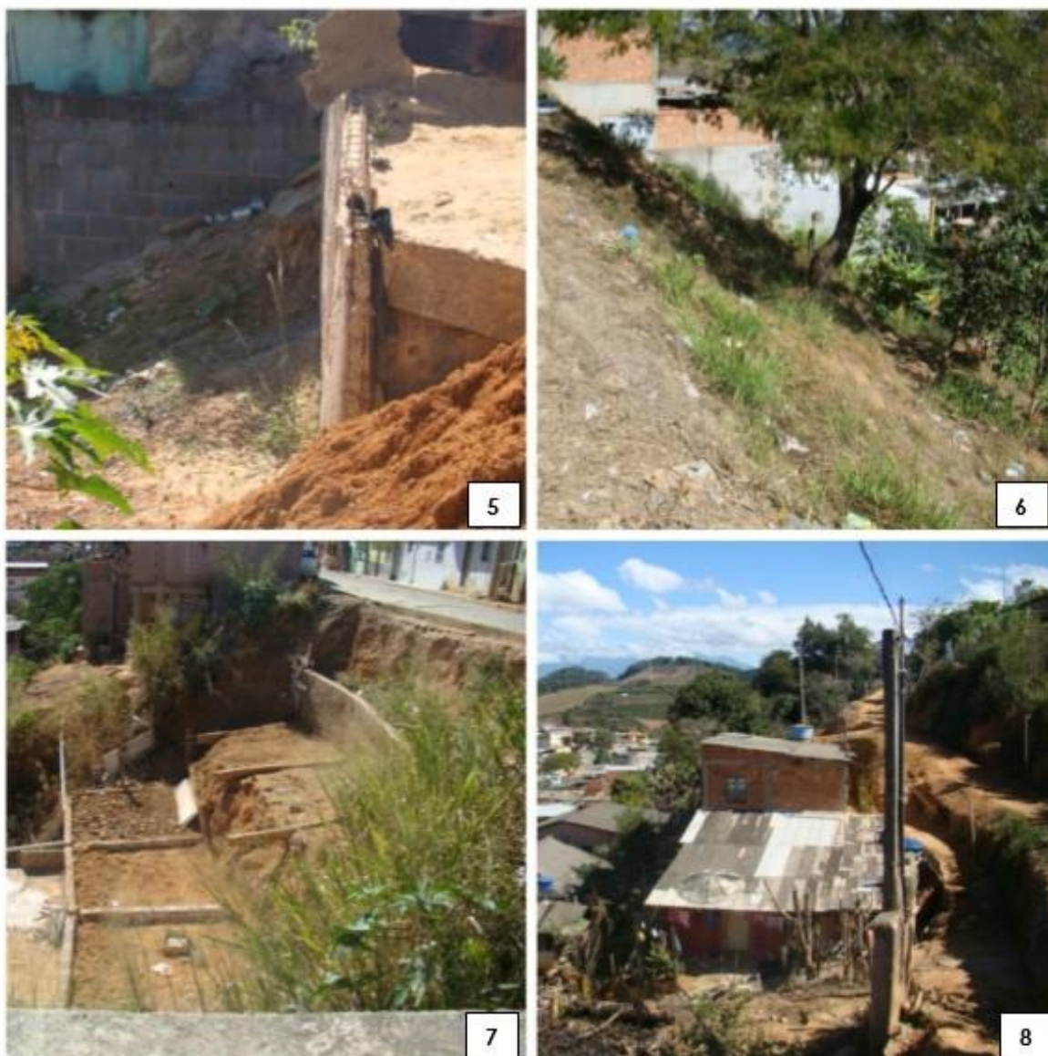
Foto 5: Moradia sofreu colapso por saturação do solo e deslizamento em talude de corte e aterro. Foto 6: Encosta de alta declividade, no caso, ponto de aterro, com lixo e entulhos e as árvores inclinadas indicam a movimentação do terreno. Foto 7: Casa construída sem fiscalização, em encosta, com pavimentos apoiados no talude de corte, potencial para deslizamentos de grande porte. Foto 8: Casa encaixada em talude de corte, e a ausência de sistema de drenagem, colocando em risco as casas a jusante (efeito dominó).
